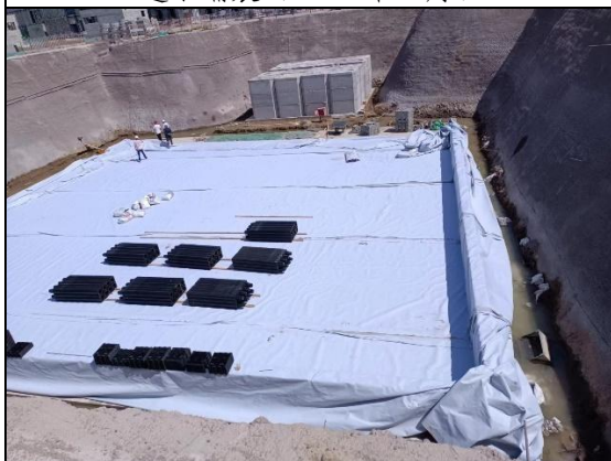
雨水调蓄池 (2023 年 4 月)
