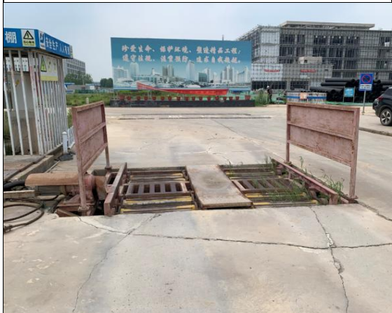
洗车沉淀池（2019 年）
