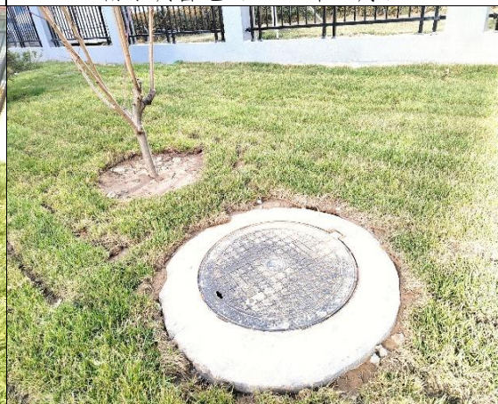
雨水调蓄池 (2023 年 12 月)
