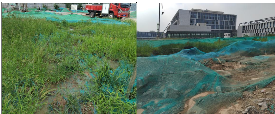
图 5.4-1 海河"23·7"流域性特大洪水后现场照片
