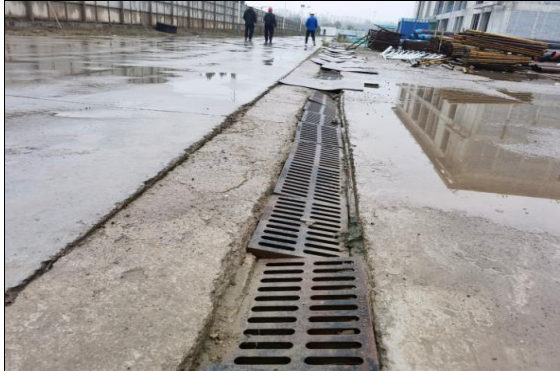
临时排水沟（2019 年）
