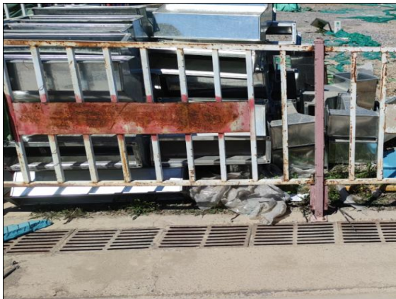
临时排水沟（2019 年）
