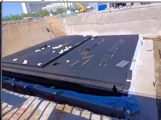
雨水调蓄池 (2023 年 4 月)
