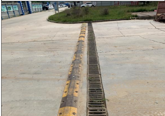
临时排水沟（2019 年）
